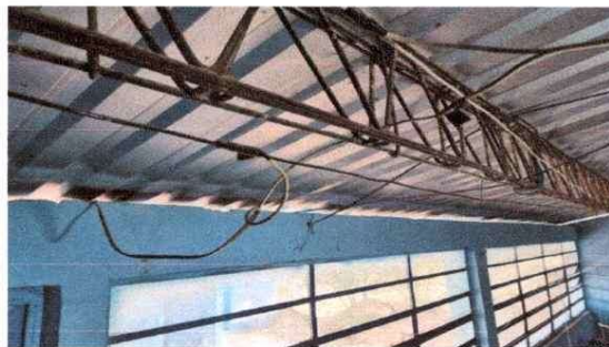
Foto 17.3: Cableado electricophdgo modulo Aulas
